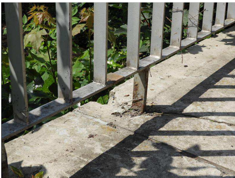
Koroze patek zábradlí
