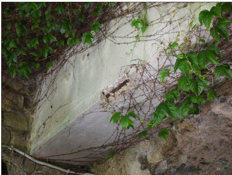
Detail trámu rozšíření - odtržení krycí vrstvy výztuže v důsledku zvětšování objemu korozních produktů výztuže
