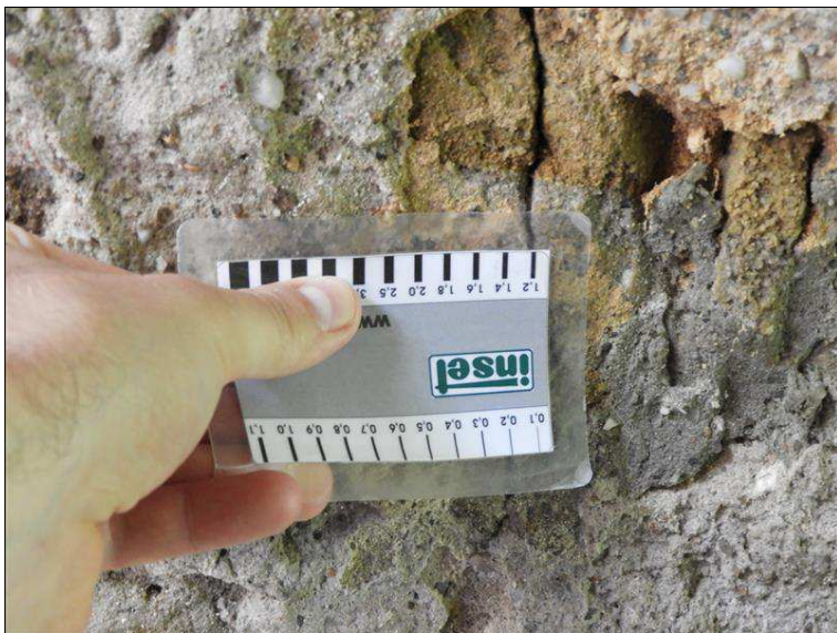
Detail OP2 - trhlina přes celou klenbu šířky do 1,2 mm
