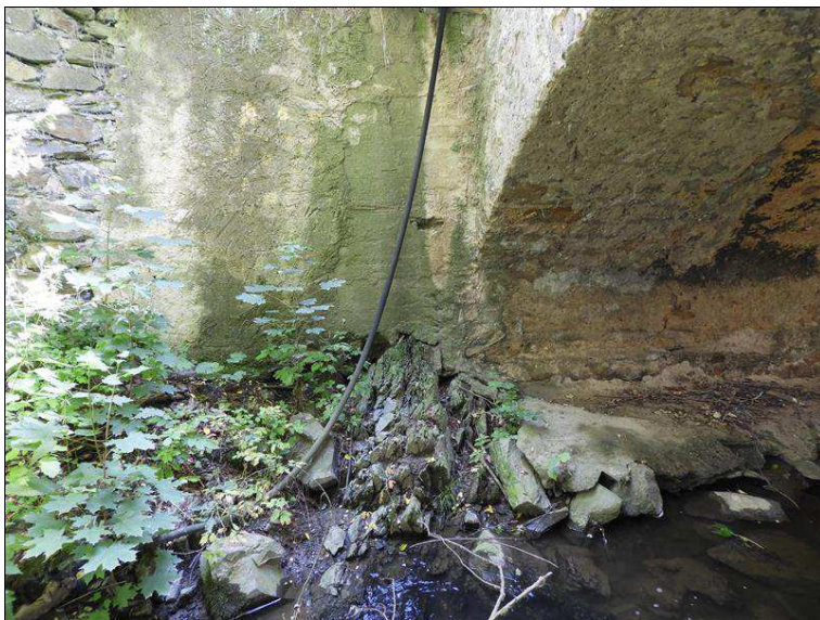
Pohled na křídlo OP1 pravé
