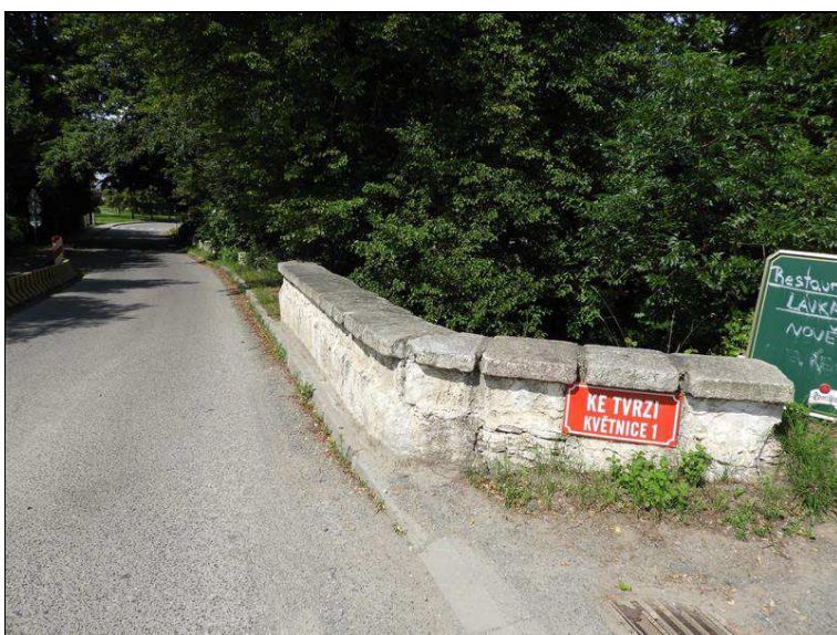
Pohled na krajnici zprava - prorůstající vegetace podél krajnice, hromadění nečistot
