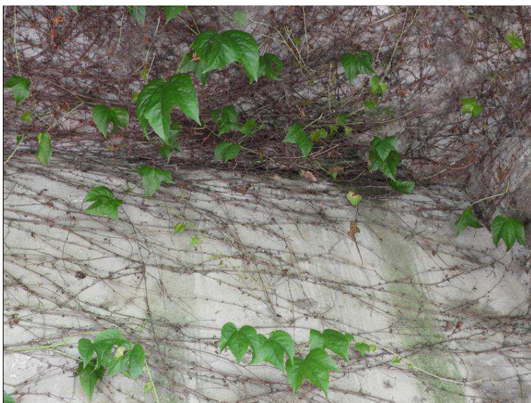
Detail NK rozšíření - výrazné stopy po zatékání a zelené výluhy
