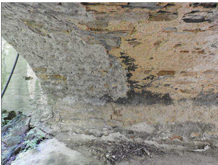
Pohled OP1 - hloubková degradace zdiva, zvětrávání, povlak, stopy po zatékání, vydrolená malta ve spárách
