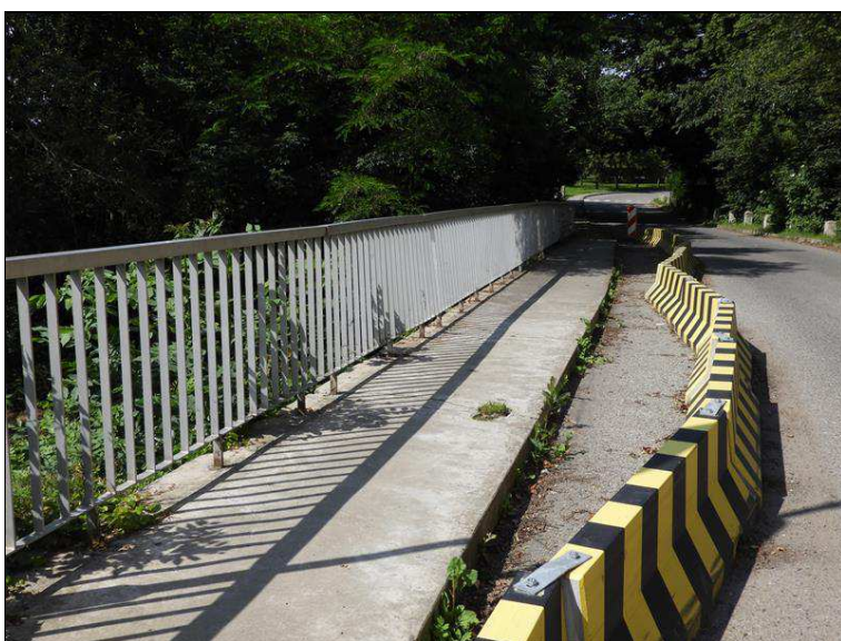
Pohled na chodník - prorůstající vegetace podél krajnice, hromadění nečistot
