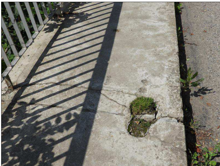
Detail chodníku - trhliny s uchycenou vegetací
