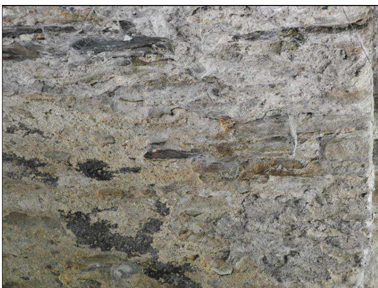
Detail klenby - hloubková degradace zdiva, zvětvávání, povlak, stopy po zatékání, vydrolená malta ve spárách
